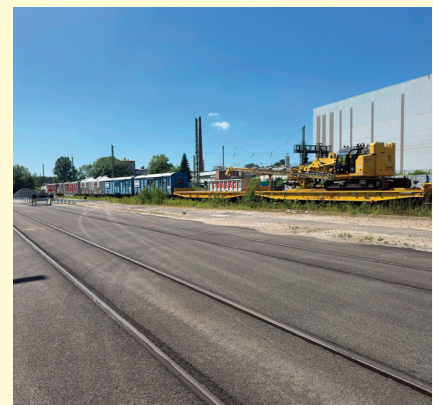
Und die notwendigen Waggons
